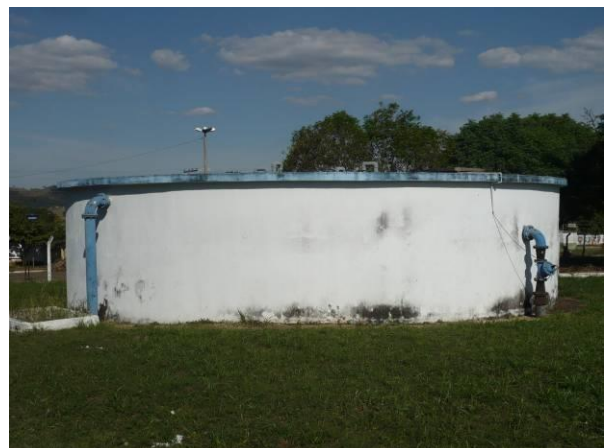
Figura 62 - Vista do RAP de 500 m 3
