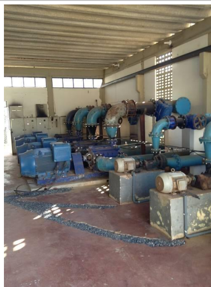
Figura 50 - Casa de Bombas
