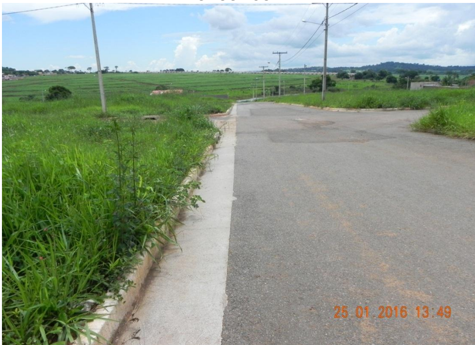
Figura 133: Rua Wolney Almeida (Sarjeta), Resid. Maria Monteiro Fonte: Secretaria de Planejamento Urbano e Habitação (2016)
