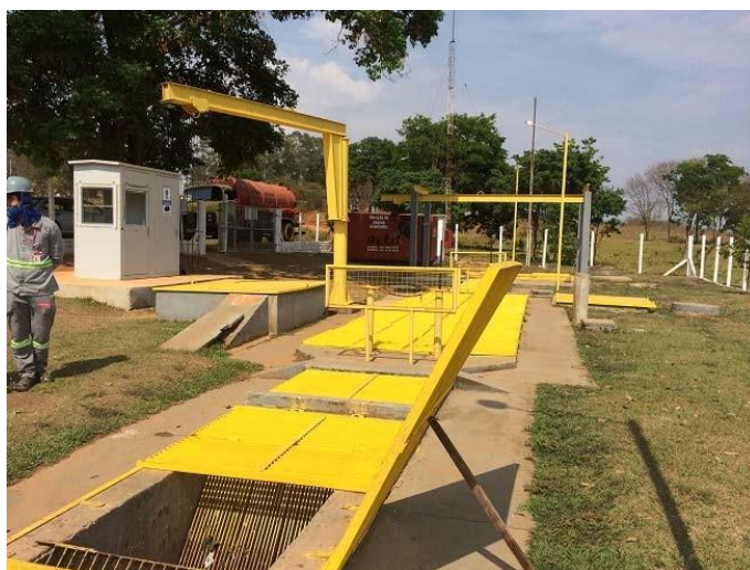
Figura 77 – Vista do Tratamento Preliminar
