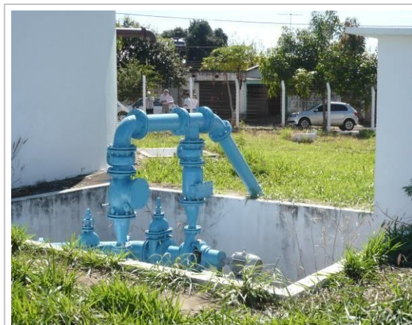
Figura 70 - EEAT Sol Dourado
