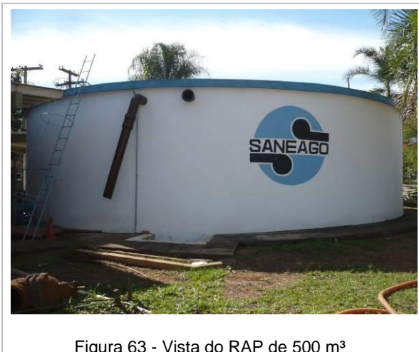
Figura 63 - Vista do RAP de 500 m 3
