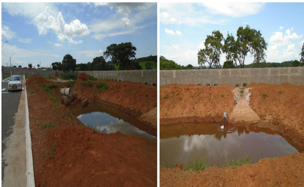
Figuras 129 e 130: Bacia de Detenção 1 (a esquerda) e 2 (a direita) no Resid. Alto do Cerrado II
