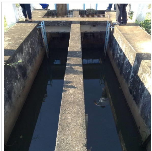
Figura 43 - Grades e Canais de areia
