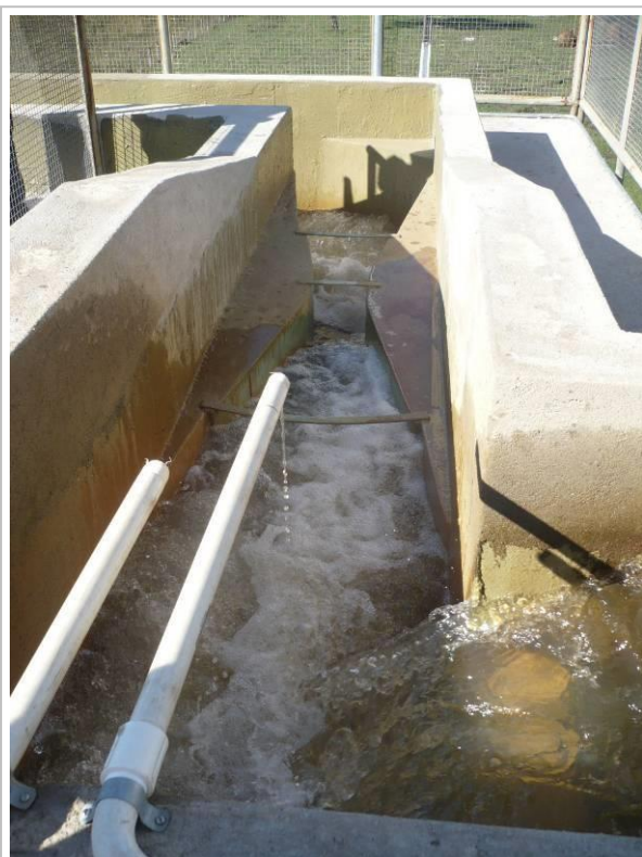
Figura 46- Entrada de Água Bruta na ETA – Vista da calha Parshall de 9” , aplicação de coagulante (Sulfato de Alumínio) e cal e canal de equalização de água bruta ao fundo.
