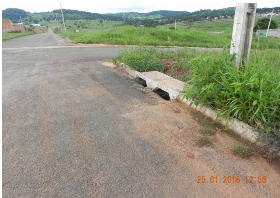
Figura 132: Rua Bento Velamil Gonçalves, Resid. Maria Monteiro (Boca de Lobo Dupla) Fonte: Secretaria de Planejamento Urbano e Habitação (2016)
