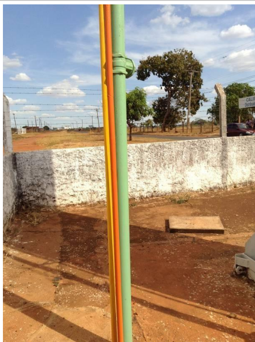
Figura 29 – Tubulações de cloro (amarela), flúor (laranja) e água do poço (verde).
