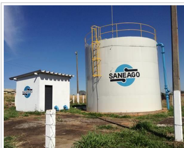
Figura 71 - Vista do RAP de 300 m 3
