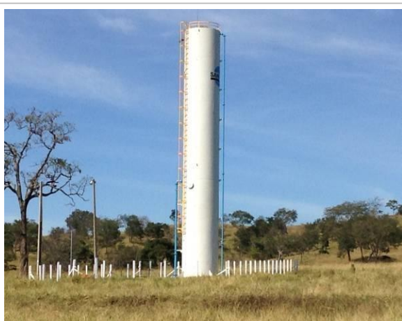
Figura 73 - Vista do REL de 100 m 3
