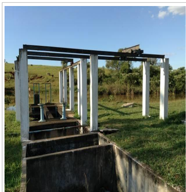
Figura 45- Vista Geral da captação
