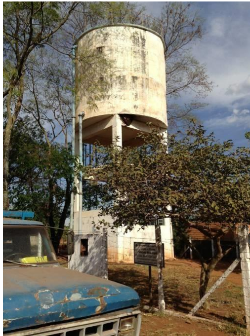
Figura 17 – CR Dona Íris - Reservatório Elevado de 150 m 3
